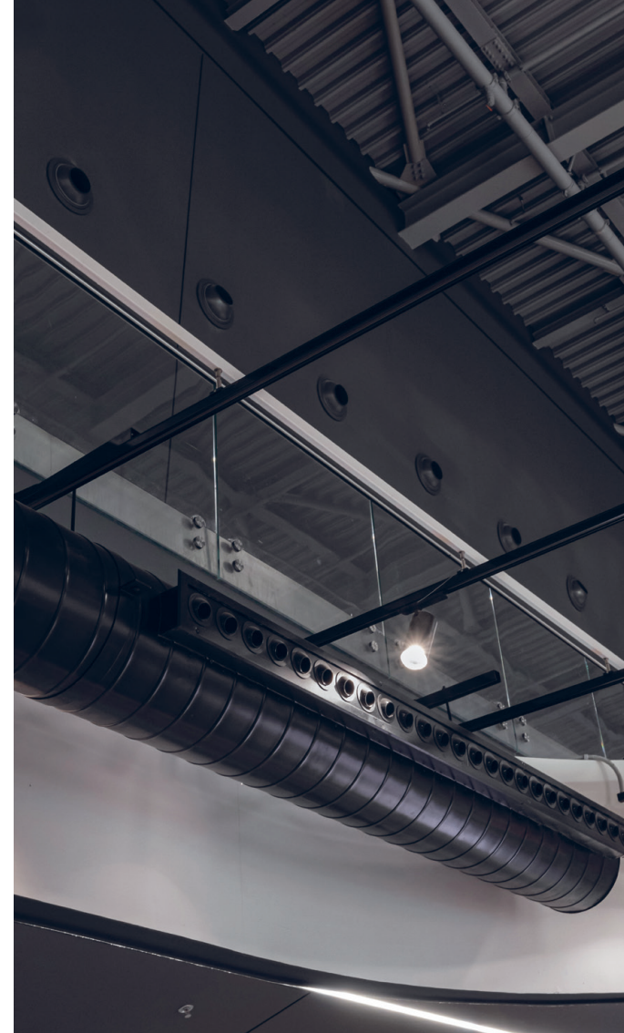
AMB-KO & AMB-AP-Ø42 Αεροδρόμιο Airport
